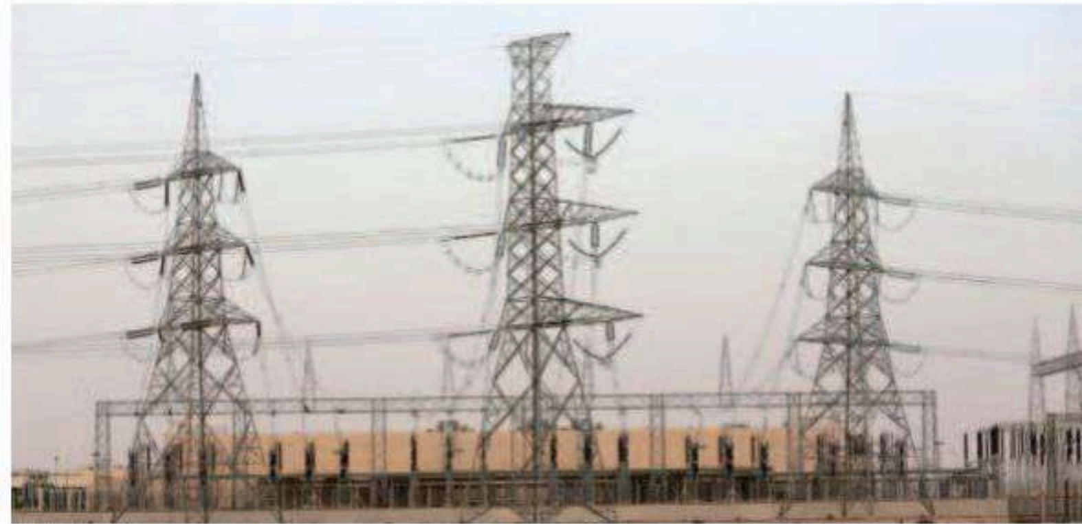
محطة سدير لتحويل الكهرباء
